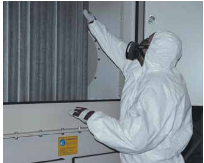
Bild 10: geöffneter Abscheider: Prüfung der Filterelemente auf Beschädigung und Beseitigen von Ablagerungen bzw. Anbackungen im Abscheider.
