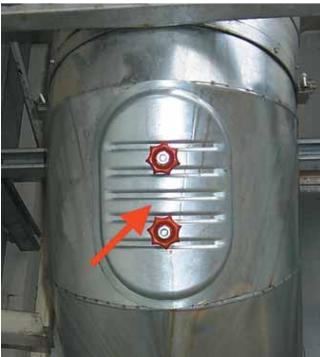
Bild 2: Inspektionsöffnungen zur Kontrolle, ob sich in den Rohrleitungen Ablagerungen oder Anbackungen gebildet haben.
