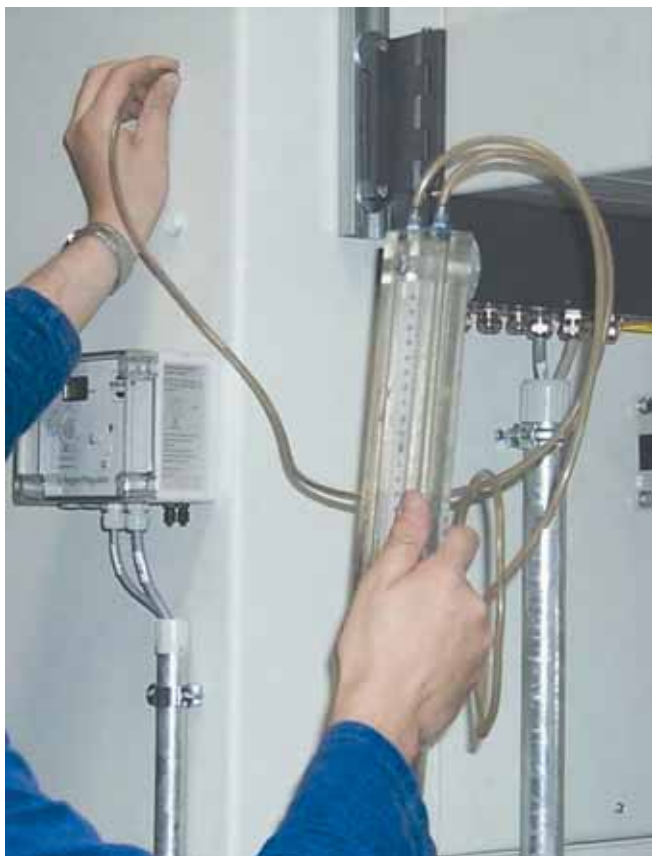
Bild 5: Überprüfung der Differenzdrucküberwachung.
